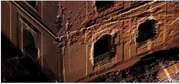
Рис.8 Деталізація сканованого зображення пошкоджень будівлі в програмному забезпеченні
